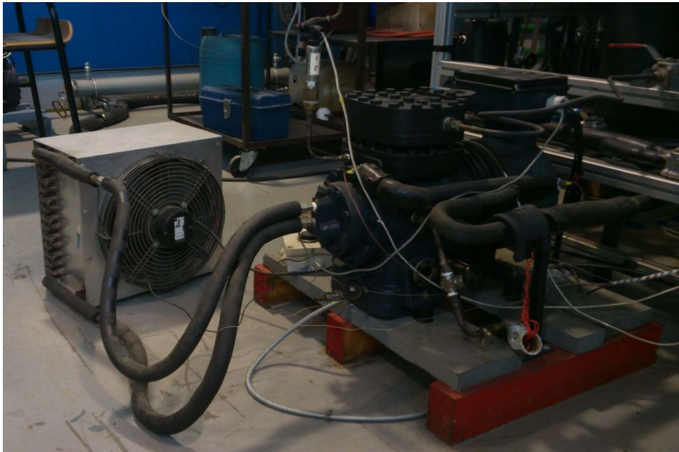
Figura 5.5.- Aerorefrigerador de aceite.
