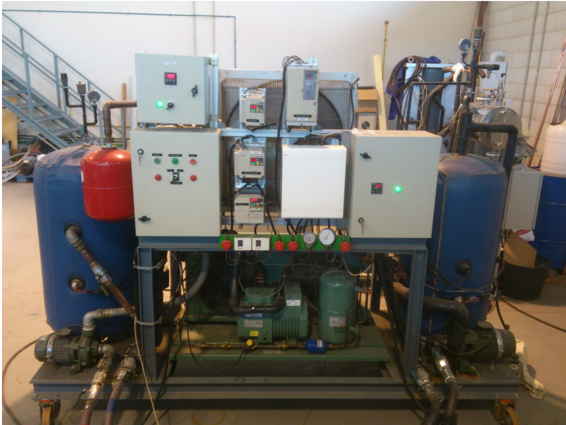
Figura 1.45.- Sistema de apoyo térmico (SAT)
